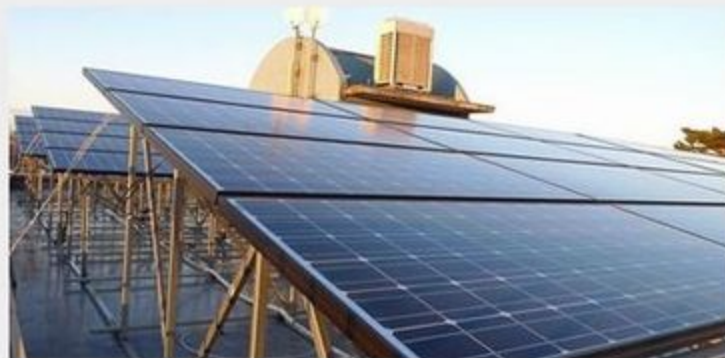
16号発電所「こだいらソーラー第1号機」 （小平市学園西町）
