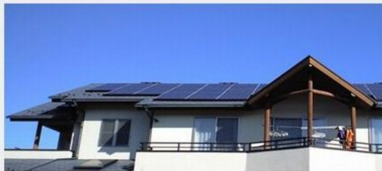
1号発電所「ケヤキ」 (東村山市久米川町)
