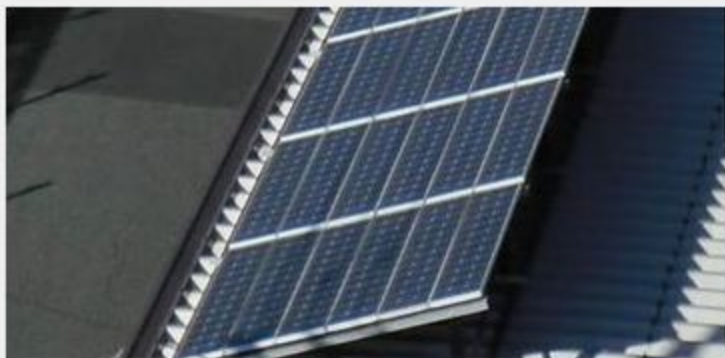
15号発電所「ながはら元始力発電所」 （大田区上池台）
